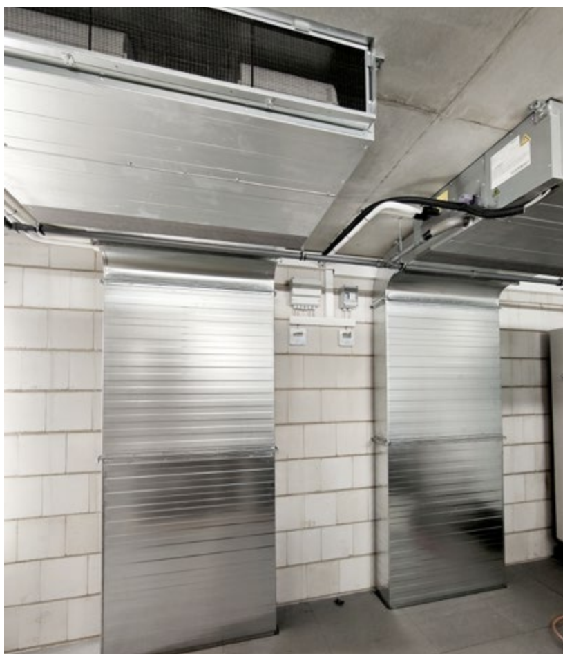
Inneneinheiten mit Kanalanschluss und Luftführung durch einen Doppelboden
