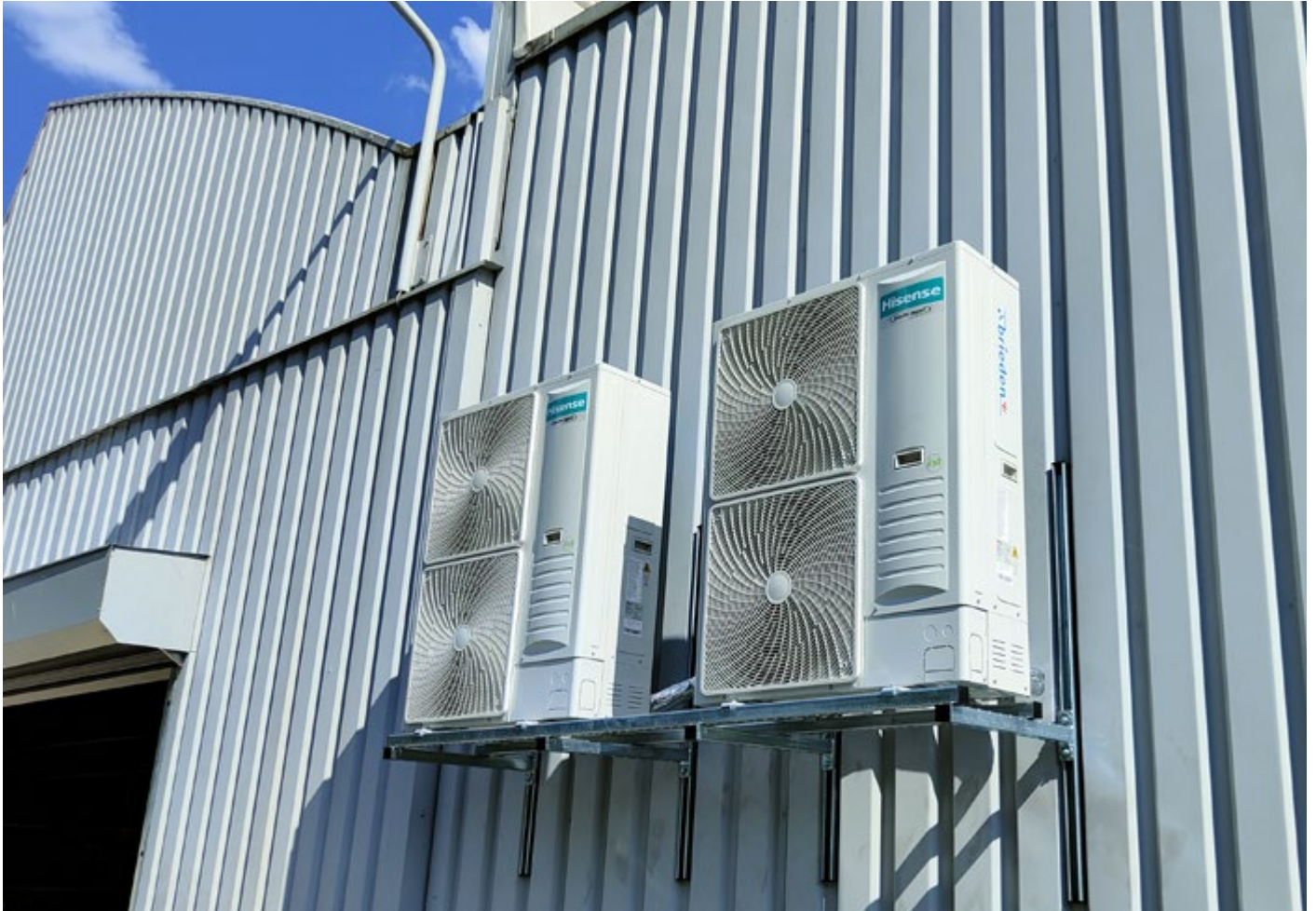
An der Fassade montierte PAC Außenheiten von Hisense
