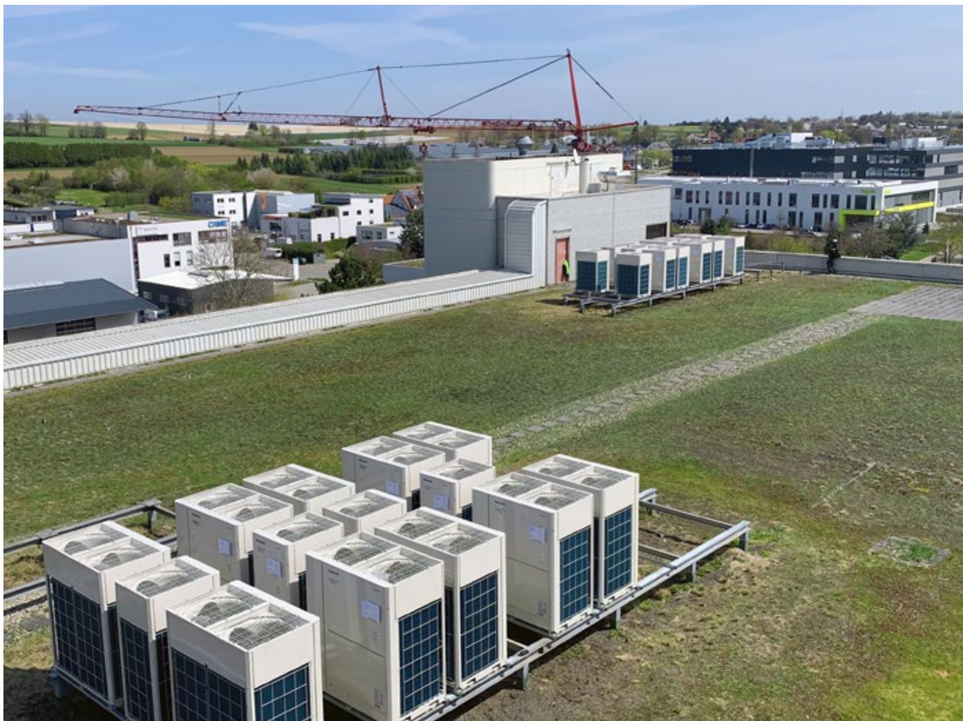
31 auf dem Dach montierte VRF-Außeneinheiten von Panasonic
