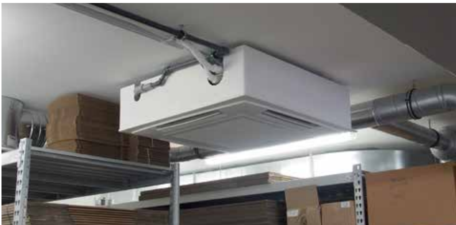
Frei abhängendes und mit individuell gefertigten Blenden verkleidetes Kassettengerät in Lagerräumen
