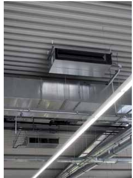
Luftverteilung im Produktionsbereich über frei hängende Zwischendeckengeräte
