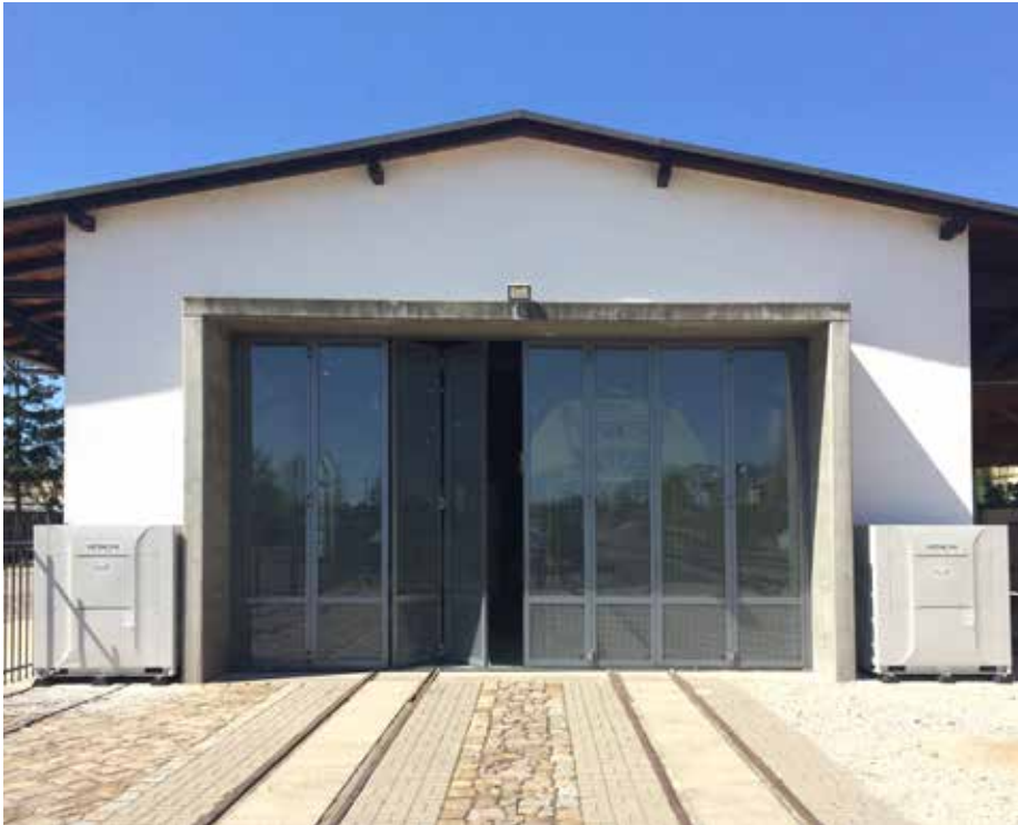
Sigma Außeneinheiten in Farbe des Sichtbetons
