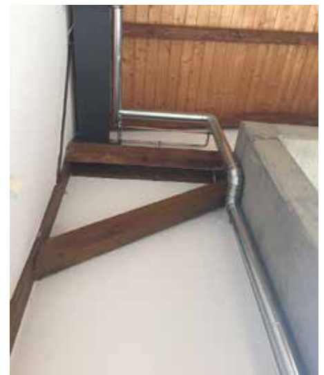
Rohrführung im Charme des 20. Jahrhunderts
