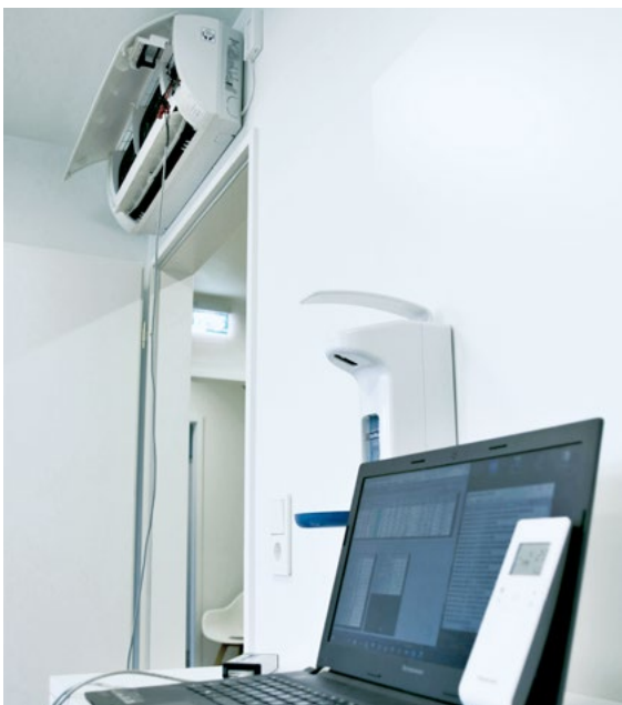
Inbetriebnahme des Klimasystems
