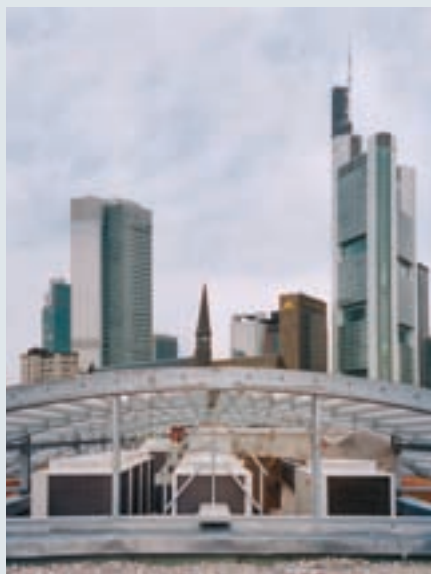
Die Klimatisierung des „Maineums“ erfolgt mit 68 VRF-Inneneinheiten und zehn Außeneinheiten
